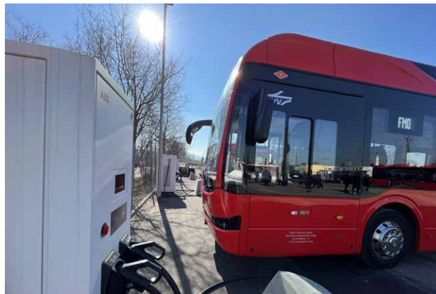
Der Landkreis stellt den Busunternehmen eine Trafostation, sechs Schnellladestationen, vier Doppelladesäulen und zwei Einzelladesäulen zur Verfügung. © Landratsamt Karlsruhe, Janina Keller-Raviol
