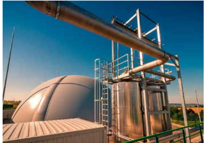
Für die Gasaufbereitung: Feinentschwefelung mittels Aktivkohlefilter
