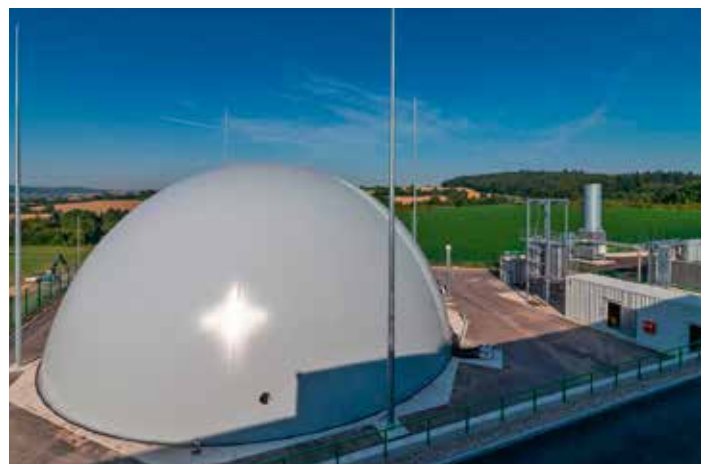
Gasspeicher mit einem Volumen von 5.000 m 3
